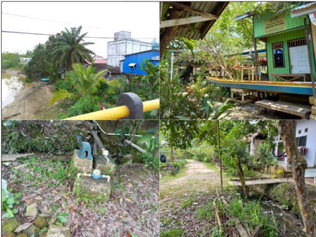
Gambar 3. 8 Kondisi Kekumuhan RT 14 Kelurahan Long Kali
